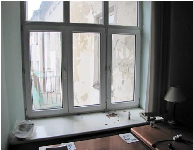
Wnętrze lokalu biurowego – okna PCV, widoczne ubytki na elewacji.
