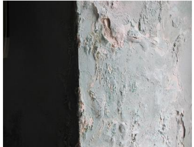
Wnętrze lokalu biurowego – odparzenia tynku.
